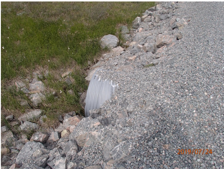
Photograph D2-4: R-04 km 12+050
