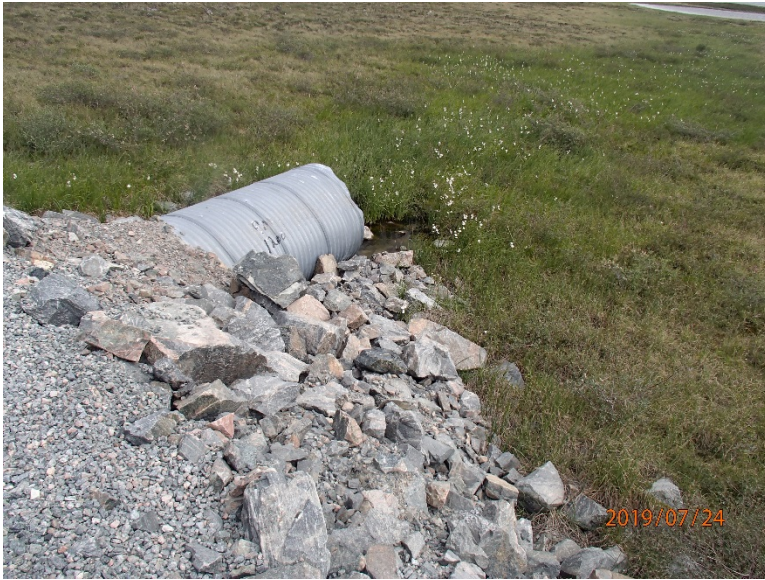
Photograph D2-3 R-04 km 12+050
