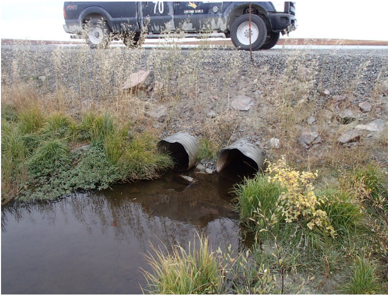
Photograph D1-3: PRC2 km 0+470
