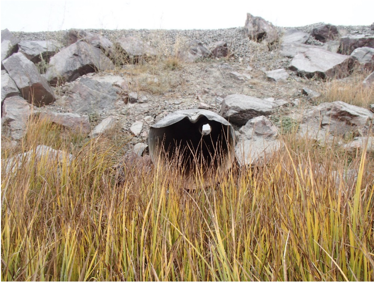
Photograph D1-1: PRC1 km 0+430
