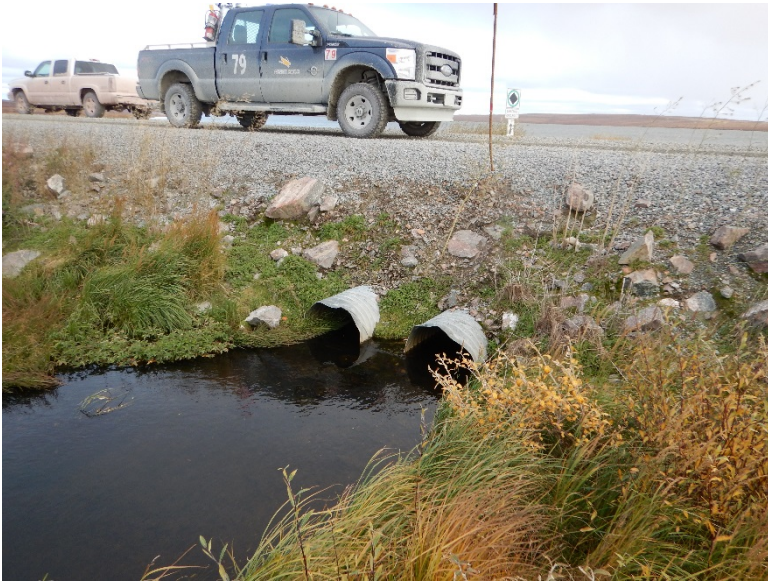
Photograph D1-3: PRC2 km 0+470
